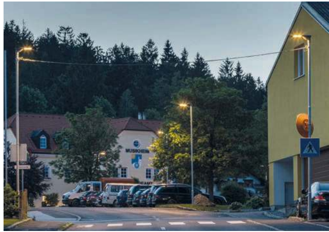
Im oberösterreichischen Kirchschlag ist man in Sachen Licht fit für die Zukunft. Die Streetlight 20 von SITECO beleuchtet hier Straßen und Fußgängerüberwege, teils mit adaptiver Twilight-Steuerung.
