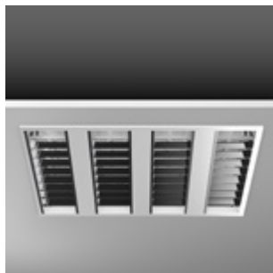
Altanlage mit Spiegelrasterleuchte
